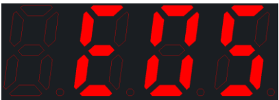
故障代号显示(外部电源故障)
