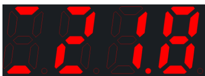
2#水泵电流值（单位：A）
