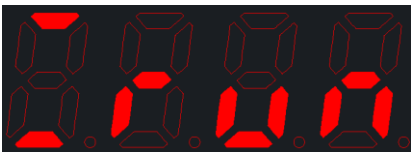
2#水泵运行(不使用互感器)
