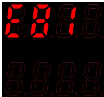
故障代号显示 (面板主机通讯异常)
